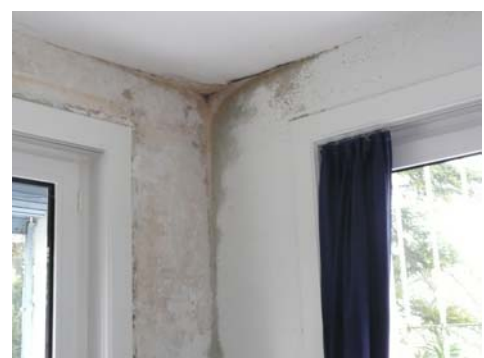
Schimmelpilz an Aussenecke Wand/Decke
